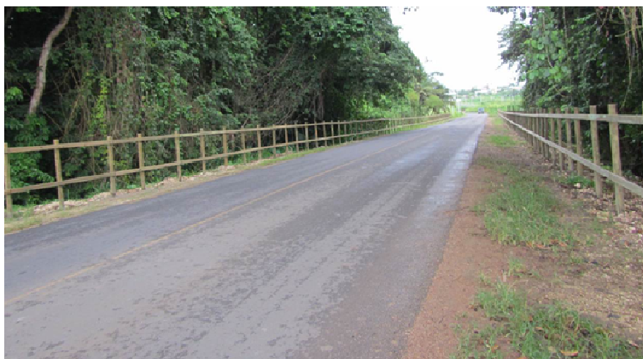
Photographie 3 : Exemple de barrières
