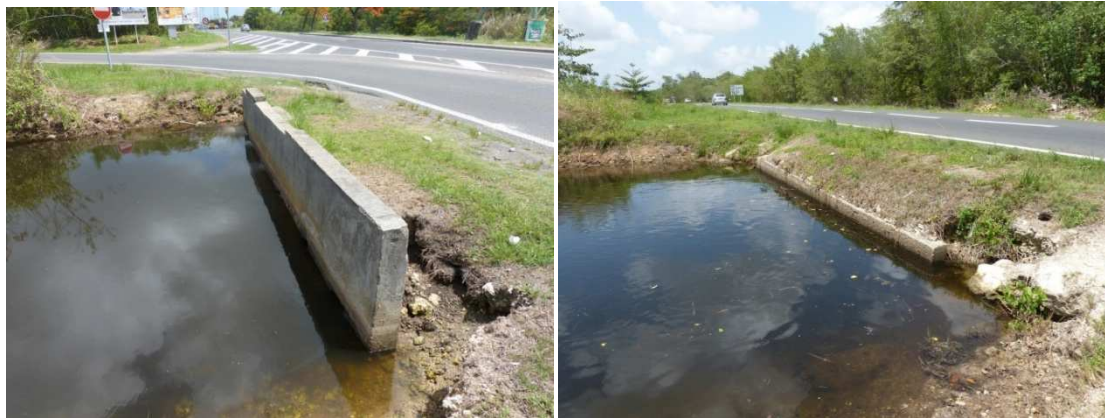
Figure 17 : principaux ouvrages de franchissement de la RD24
