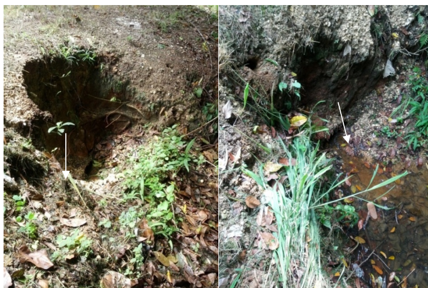
Figure 2 : buses fortement envasées sous la RD32
