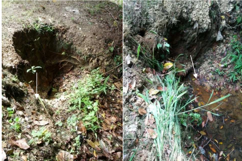
Figure 16 : buses fortement envasées sous la Voie Verte
