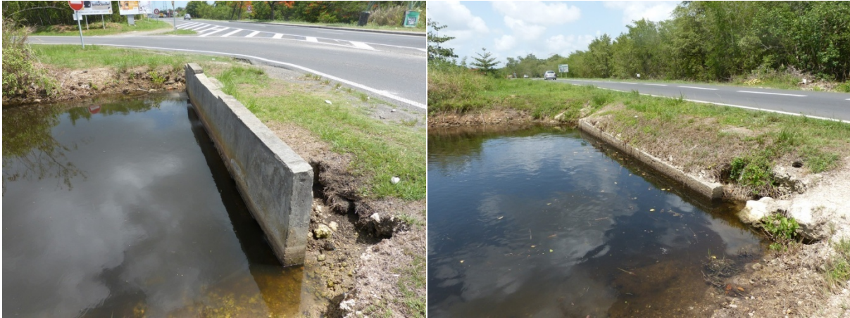
Figure 3 : principaux ouvrages de franchissement de la RD24
